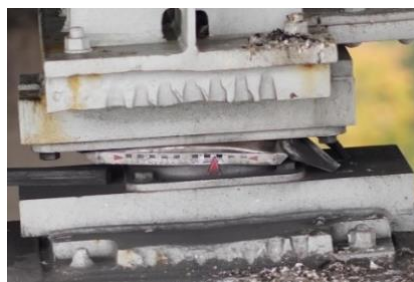
Lokalisering av avvik: NAS har registrert mange viktige funn for SVV over årene, som f.eks dette skadde brulageret.
