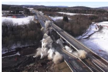
Kollapsen av Skjeggestad bru i 2015 ble starten av NAS karriere innen krisehåndtering.
